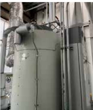
II ASラインの熱媒ボイラー
