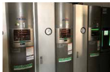
本社に設置した貫流ボイラー
