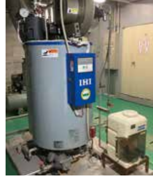
北海道工場に設置した貫流ボイラー
