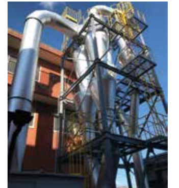
II ASライン集塵機に取り付けられた防音装置
