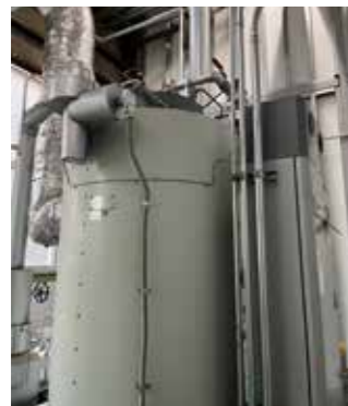
II ASラインの熱媒ボイラー
