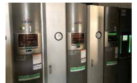
本社に設置した貫流ボイラー
